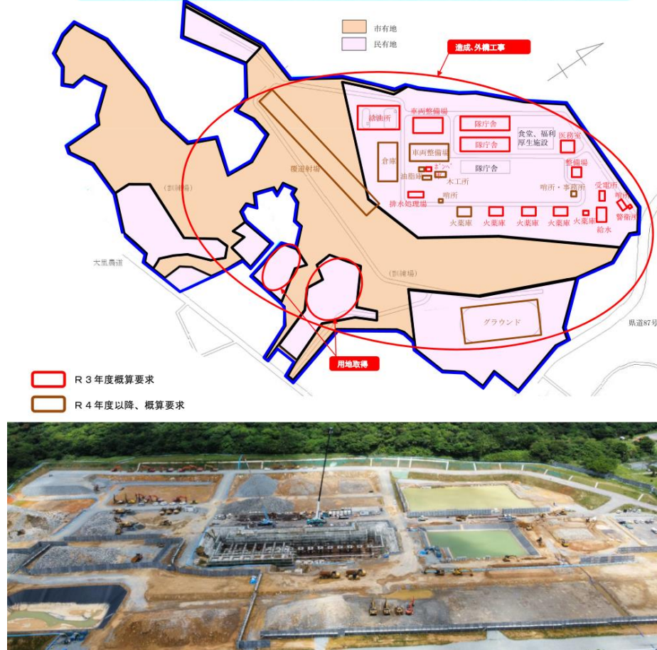
図2 防衛省が、2020年10月に伊波洋一参院議員に示した、2021年度概算要求で建設予定の施設の配置図(上)と、2021年7月26日(月)に撮影されたドローン写真(下)
